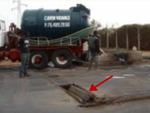
Grille avaloir de récupération de liquides endommagé
