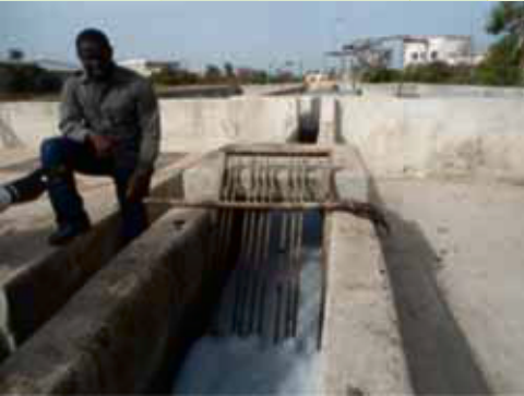
Dégrilleur endommagé et rouillé
