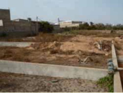
Lits de séchage délabrés et vannes défectueuses
